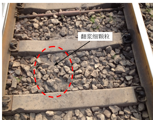
图1 翻浆冒泥典型断面
